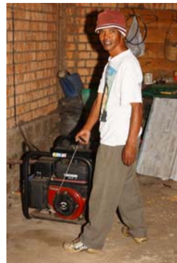
Wächter mit Notstromaggregat in der Villa Mamisoa
